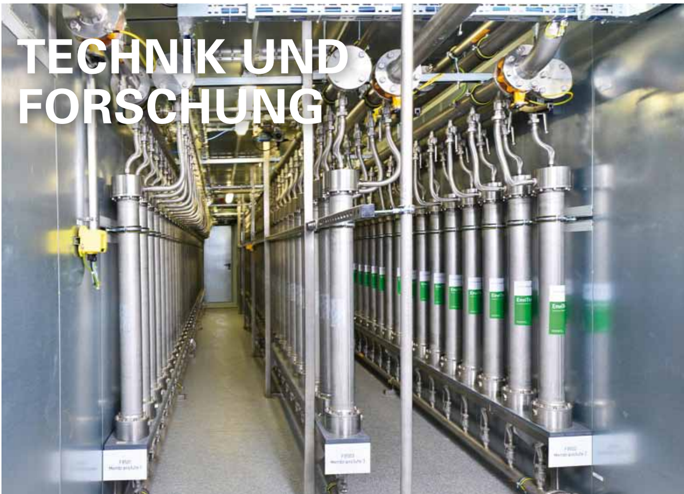
Sowohl im sachsen-anhaltinischen Sachsendorf als auch im nahe gelegenen Köckte kann der Methangehalt mittels Nutzung der hochselektiven Membranmodule auf über 97 Prozent gesteigert werden (hier die stehende Variante).
