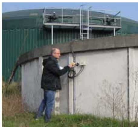
Sichtbare Mängel nimmt Dirk Terkowski bei einer Begehung auf und bespricht sie vor Ort mit dem Kunden.
