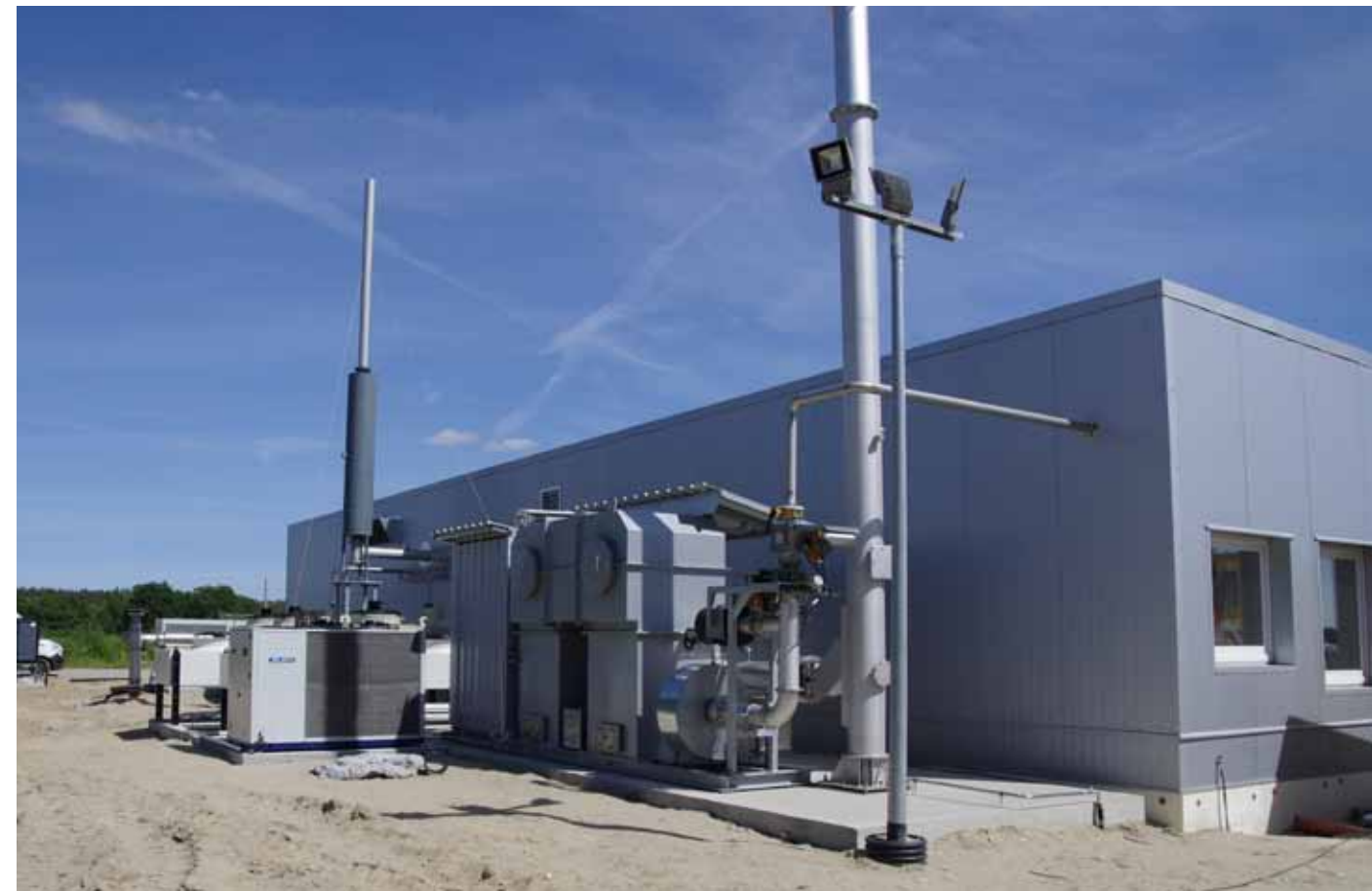
Außenansicht der ebenfalls 350 Nm³/h-leistungsstarken integrierten Gasaufbereitung in Köckte
