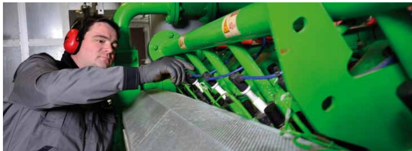
Ein starkes Technik-Team gewährleistet, das für die Wartung nötige Abstellen der Anlage möglichst kurz zu halten. Wir sind einer der wenigen Anbieter in der Branche, der in der Lage ist, innerhalb eines Tages gleichzeitig unterschiedliche Wartungen durchzuführen.
