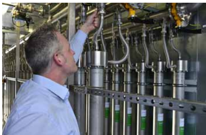
Sowohl die 75 Nm 3 -starke Demonstrationsanlage (oben) als auch die 350 Nm 3 /h-leistungsstarken EnviThan-Anlagen (unten) laufen von Anfang an stabil und liefern die erwartete Menge und Qualität an Biomethan.
