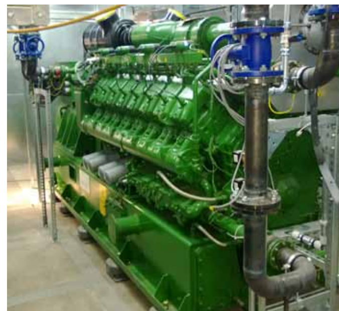
Das im September 2013 bei Leipzig in Betrieb genommene BHKW mit einer elektrischen Leistung von 1,5 MW liefert eine flexible Stromerzeugung bei gleichzeitig optimierter Wärmeauskopplung und stellt zusätzlich Regelenergie bereit.
