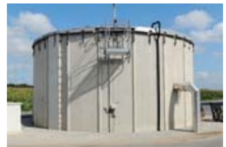
Im Annahmebehälter wird die Gülle zwischengelagert.
