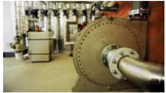
Der Verdichter erhöht den Gasdruck auf 90 mbar, damit das Biogas danach im BHKW verwertet werden kann.
